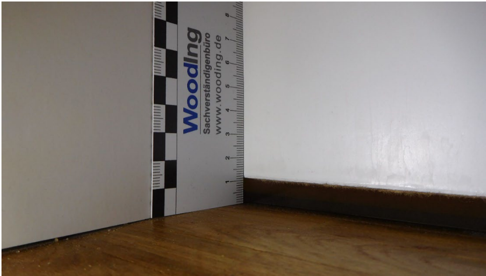
6) Unterschnitt an der Innentür zum Bad als Überströmöffnung – besser: ein Gitter im oberen Bereich der Tür
